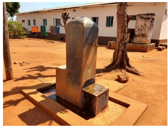
診療所に設置された既存公共水栓(マジュネ郡)
