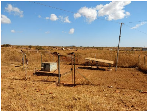
管路系給水施設用深井戸とピット(ムエンベ郡)
