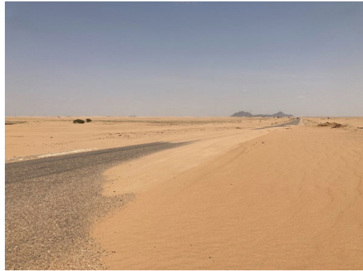
アトバラーハヤ道路 舗装が砂で覆われた区間
