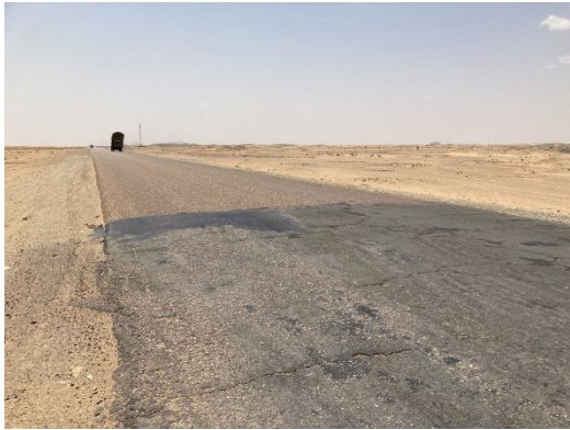
アトバラーハヤ道路の路面性状 写真奥が中国、手前がインド業者施工
