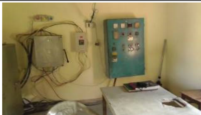
4-2 Kanchanbari ポンプ場 (電気室状況 管理室にもなっている)
