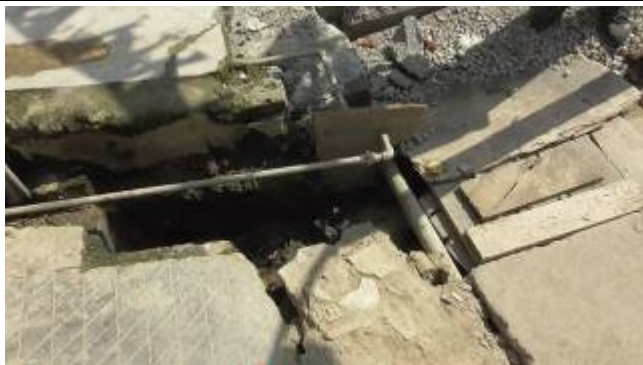
14-1 給水管敷設例（地表面に配管され、排水溝上にある 汚水混入のリスクがある）
