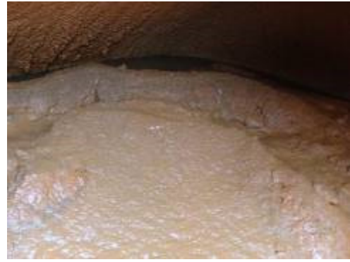
12-2 Rani ポンプ場の鉄・マンガン除去装置の維持管理状況（錆が目立つ、ろ材洗浄が不十分）
