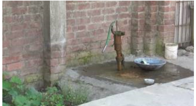
8-2 市内の路側に設置されているハンドポンプ
