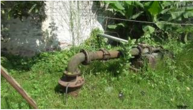
5-1 BFM ポンプ場 (井戸状況 配水池無しで直接配水する)
