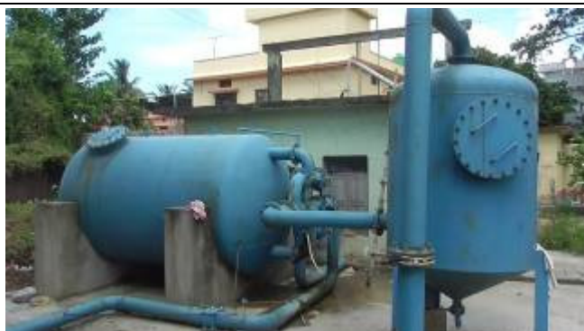
3-2 Munal Path ポンプ場 (鉄・マンガン除去装置を使用中)
