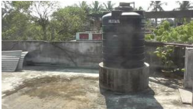
13-1 家庭に設置されている貯水タンク（給水された水を貯水している）
