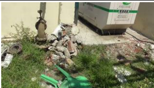
4-1 Kanchanbari ポンプ場 (井戸状況 清掃ができていない)
