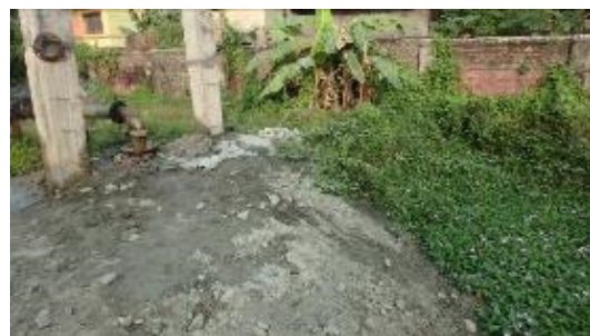
コンクリートフェーシングが薄いケース
