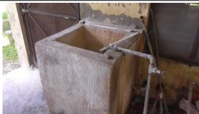
2-2 Tinpaini ポンプ場 (さらし粉溶解槽 ポンプ注入している)
