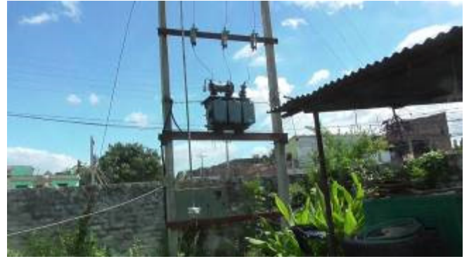
5-2 BFM ポンプ場 (変圧器 水道事業者側で設置が必要)
