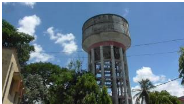
1-1 Devkota ポンプ場 (高架水槽から配水している)
