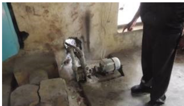
1-2 Devkota ポンプ場 (井戸水にポンプで塩素注入している)
