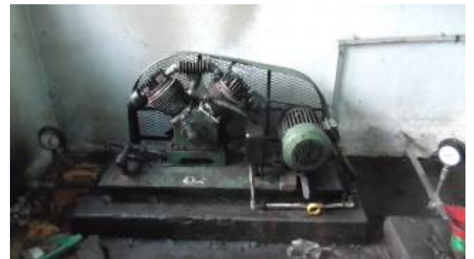
6-2 Rani ポンプ場 (鉄・マンガン除去装置のばっ気用コンプレッサー)
