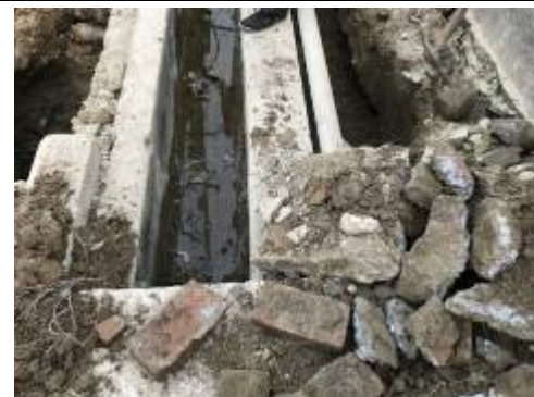
14-2 給水管敷設例（排水溝横の地表面に近くに配管されており、損壊・漏水のリスクがある）
