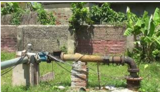
2-1 Tinpaini ポンプ場 (井戸状況 流量計不稼働)
