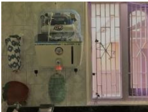
13-3 家庭に設置されている浄水器（ハンドポンプの水を家庭で浄水している）
