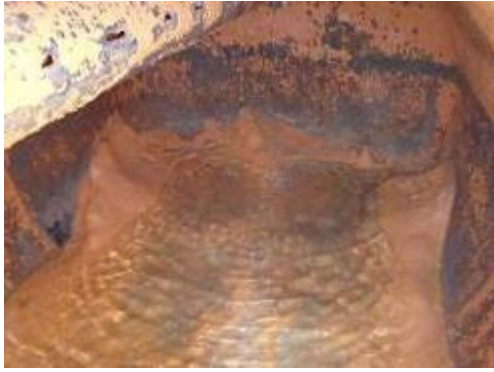
12-1 Munal Path ポンプ場の鉄・マンガン除去装置の維持管理状況（ろ過砂が流出しており、内部にろ材が無い）
