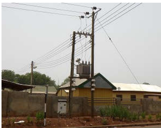
施設へ送電している変圧器
