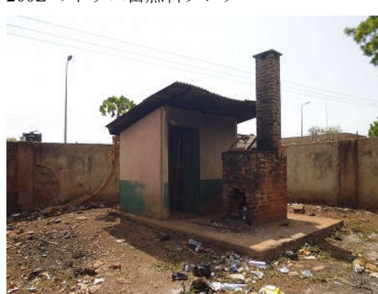
壊れており使用できない焼却炉。周囲には使用済みの注射針等が散乱している
