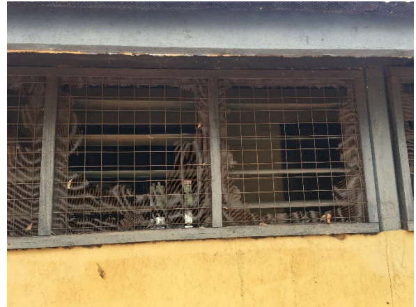
タマレ中央病院：敷地内の建物のほとんどはジャロジー+網戸の窓である。ジャロジーガラスの破損や網の破れが散見される。
