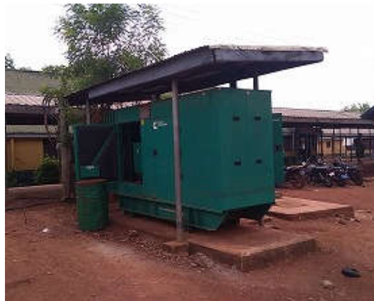
停電時に使用しているディーゼル発電機と200Lのドラム缶燃料タンク
