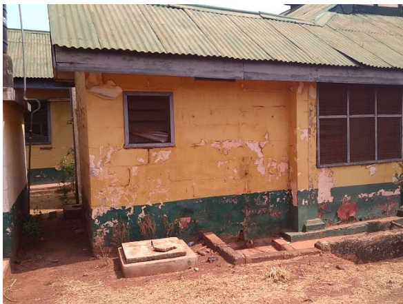
タマレ中央病院：産科病棟 老朽化した外壁にはクラックやペンキの剥がれが目立つ。
