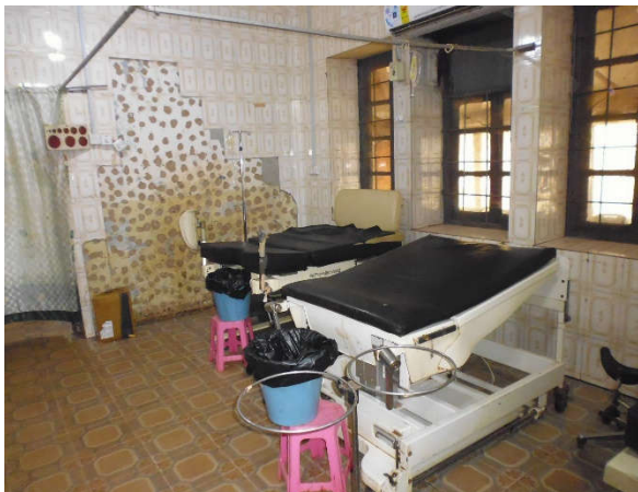
タマレ中央病院：陣痛棟の分娩室 分娩台は4台の内1台が故障中。水道がない。
