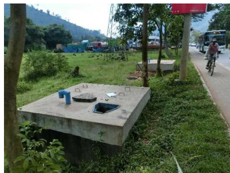
モニタリングシステム流量計用マンホール
