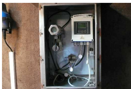
マンホール内設置の流量・圧力計のトランスミッター
