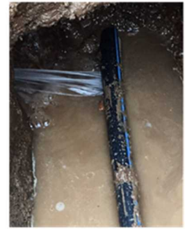
HDPE 漏水の状況
