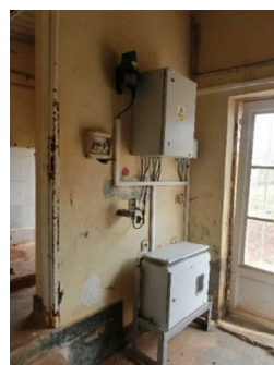
ポンプ場設置のデータロガー、トランスミッター、UPS
