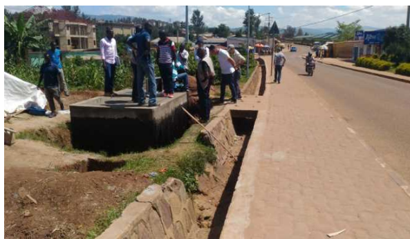
パイロットプロジェクト用マンホール
