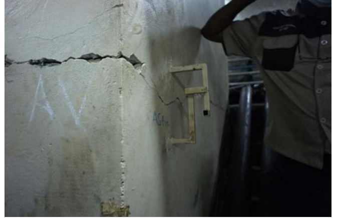
発電機基礎部
