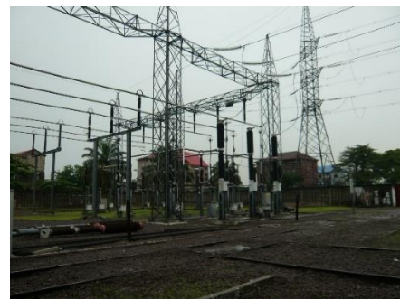
(b) 220kV 気中開閉設備エリア
