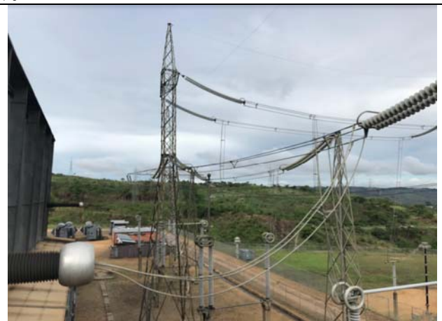
±500kVInga-KolweziHVDC 線 引き込み鉄塔
