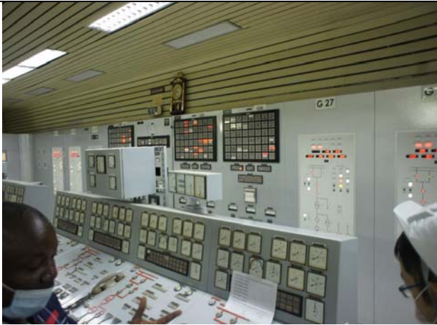
インガ第二発電所制御室
