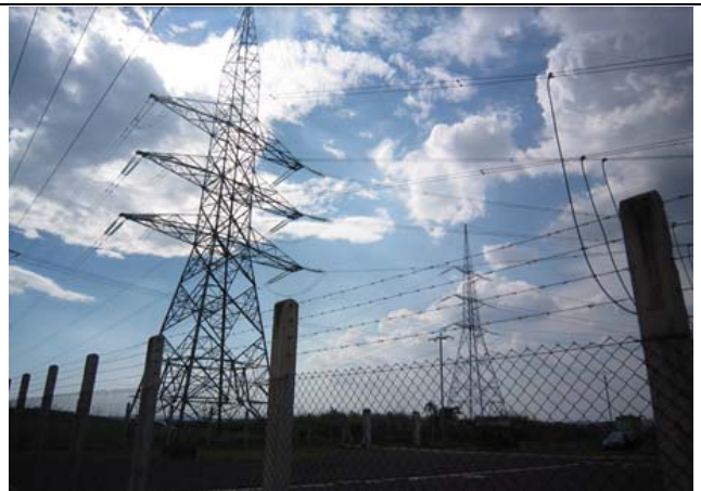
220kV Inga2 - Kimwanza 線（奥）220kV Kwilu - Kimwanza 線（手前）
