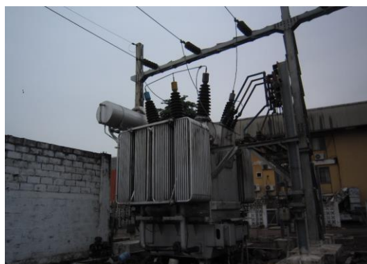
図 3-4.1 1 Gombe 変電所 70/6.6kV 変圧器（1955 年製）
