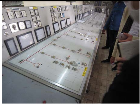
Lingwara 変電所制御卓
