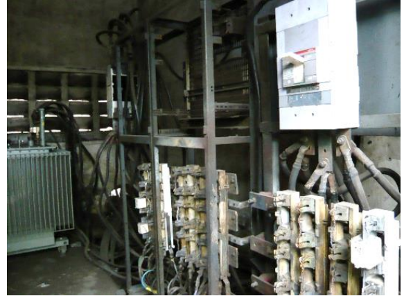
(b)変電所内部
