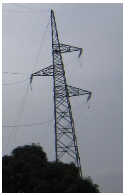
70[kV] Kasangulu-Gombe (1954 年建設)
