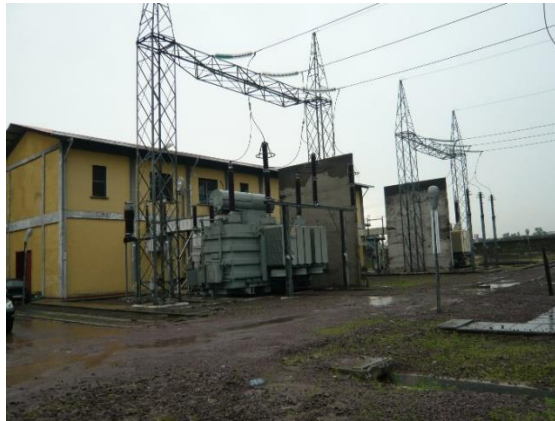
(a) 220kV/20kV 変圧器外観
