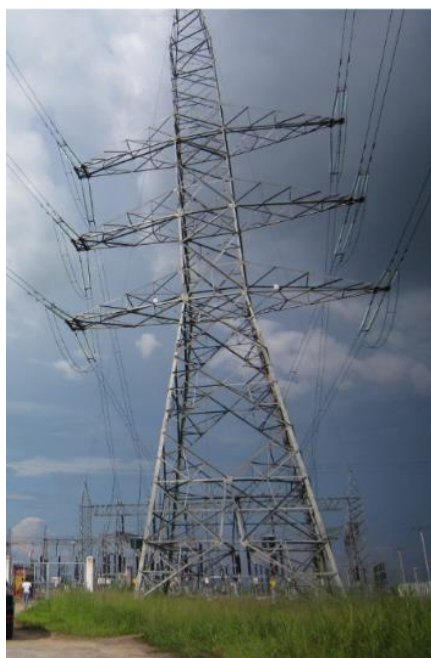
220[kV] Kwilu-Kimwenza(1974 年建設)
