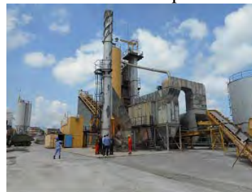
Fabrika e asfaltit
