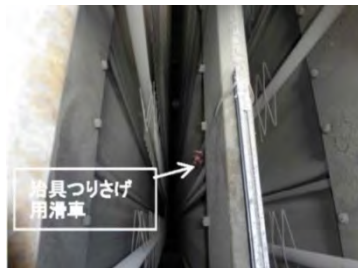
風速測定器吊り下げ治具
