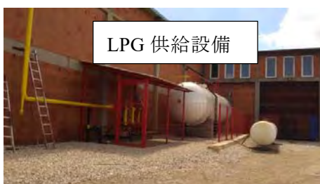
写真 3-3 2 LPG 供給設備
