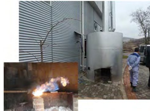
写真 3-3 6 ガスの燃焼設備
