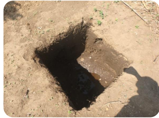
Figura 3. Fosa de infiltración.
