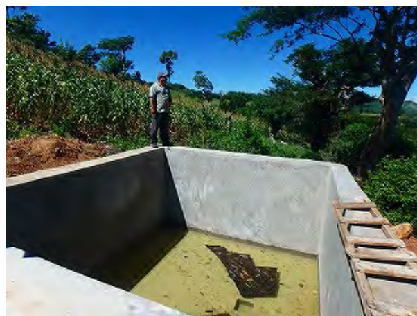
Foto 4: El Sr. Juan Machua, beneficiario del proyecto, analiza el reservorio construido por el proyecto (Parcelas de Olomega)
