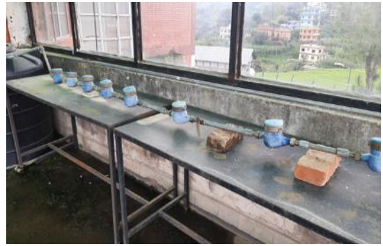
ワークショップ棟 給水メーター・テストベンチ
