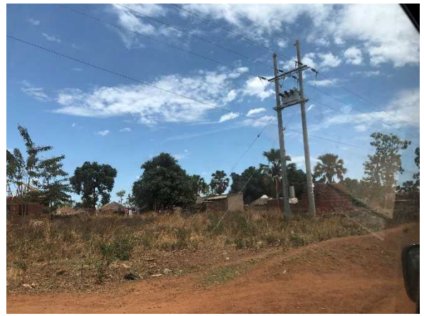
33kV 配電線用の柱上変圧器。集落の近くまで電力が来る予定である。コンクリートポールが使用されている。現在 33kV 配電線が建設中である。アルア方面から電力供給される予定である。
