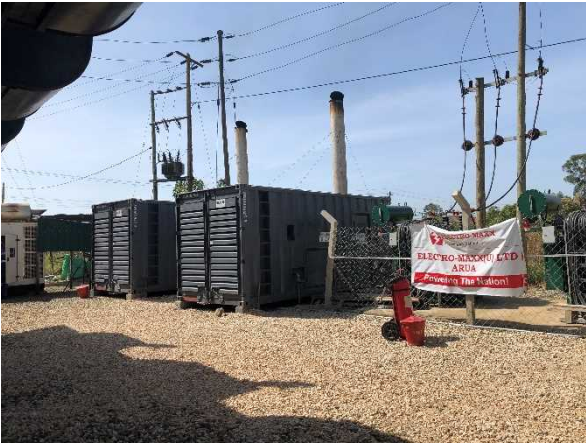
Electro Maxのディーゼル発電機。本発電所には12基の発電機があり、合計8.2MWの容量を持っている。配電事業者であるWENRECOと連絡を取り合いながら運転を行っている。
