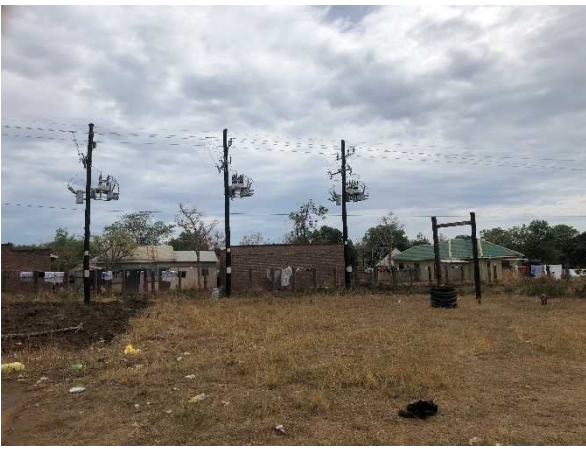
Adjumani の 33kV 配電ネットワークに接続されているキャパシタバンク。これにより無効電力調整を行っている。
