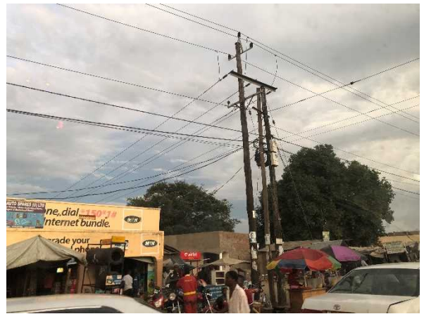
33kV 配電線と 240V 配電線。240V の低圧配電線は被覆電線が使用されている。
