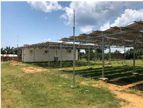
カンパラから80km程離れた、ブンジャコ島のミニグリッドサイト状況
