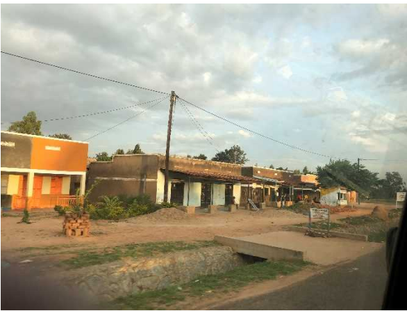
240V の低圧配電線。被覆電線が架空配線されている。
