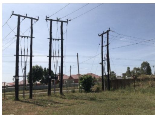
(d) Arua・Vura・Nebbi 方面へ配電する 33kV 配電線
