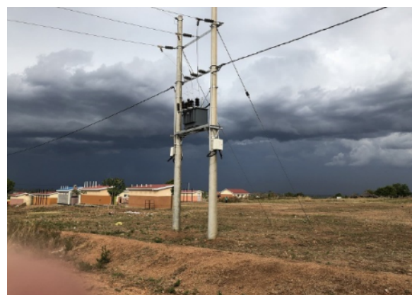
(b) Bidi Bidi の小学校施設のための 33kV 配電の引込用変圧器。Arua – Yumbe 間送電後に小学校へ電力供給される予定である。
