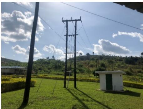
(g) アルア方面へ配電する 33kV 配電線
