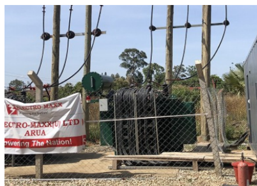
(b) 昇圧変圧器
