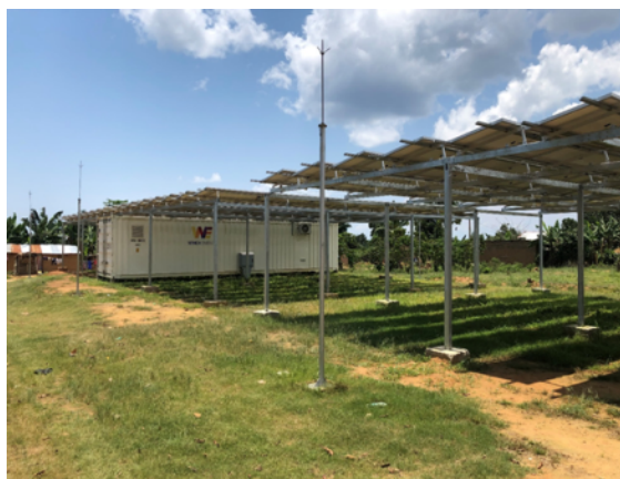
(a) 太陽光発電所
