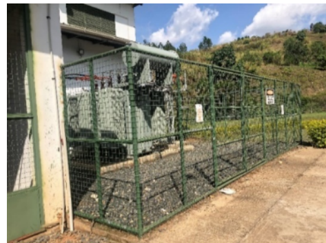
(f) 33kV 配電線へ電力供給する変電施設
