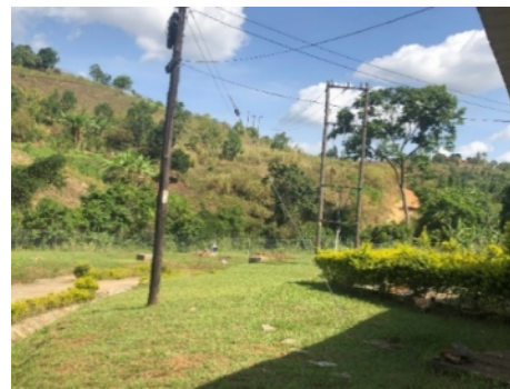
(h) ネビ方面へ配電する 33kV 配電線
