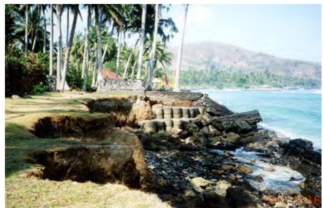
護岸が崩壊し、侵食は陸域 まで及んでいた
