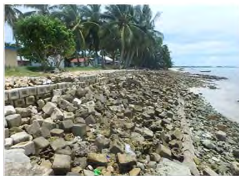
コンクリートブロックの散乱
