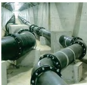
Public utility conduit
