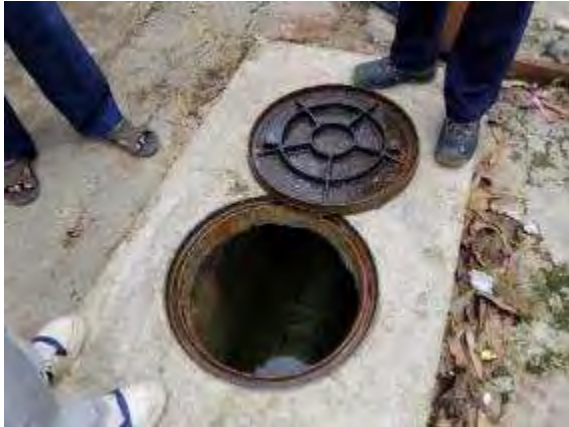
写真 2-47：流量計室入口
