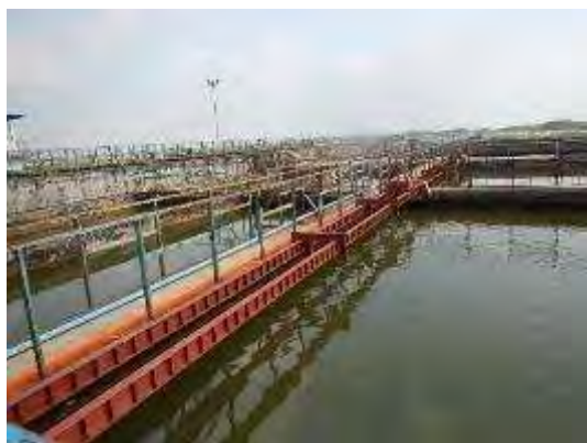
排泥用の移動式水中ポンプの架台
