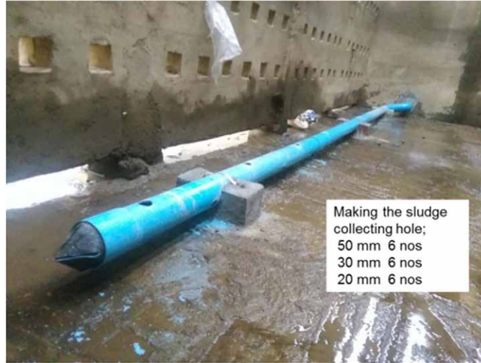
写真 2-69 : Phase1No. 1 沈殿池に増設された排泥パイプ
