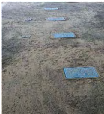
漏水探査部給水装置配管
