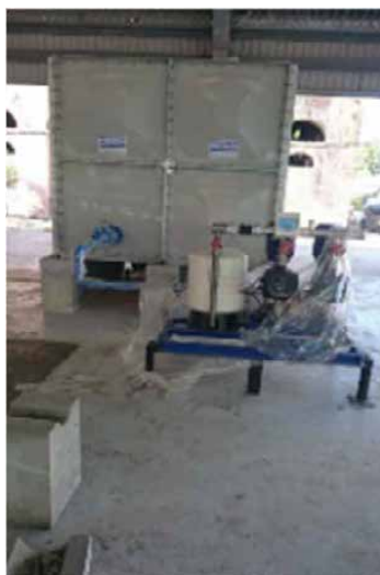
貯水タンク～ポンプへの配管
