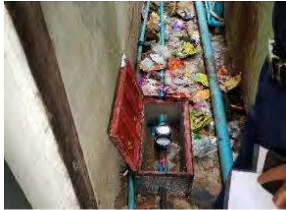
写真 2-48：WRAWSA 製メータボックス
