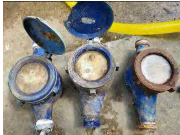
写真 2-60 : 取り外した破損メータ
