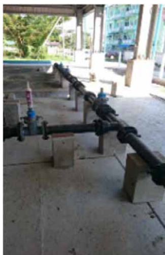
配管トレーニング部配管
