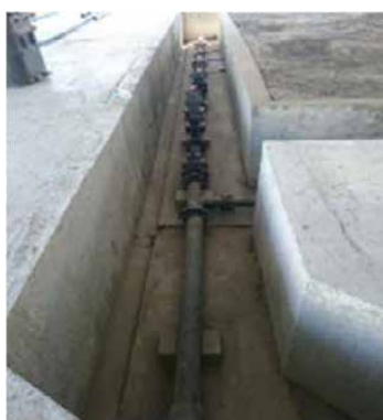
地下ピット内配管
