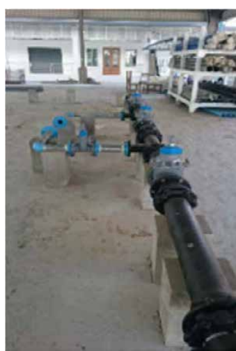
循環ポンプ部周囲配管
