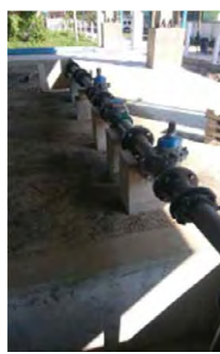
流量計設置部配管
