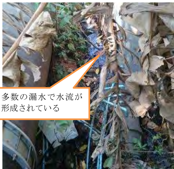
写真 2-36 : 小口径配水管からの漏水状況
