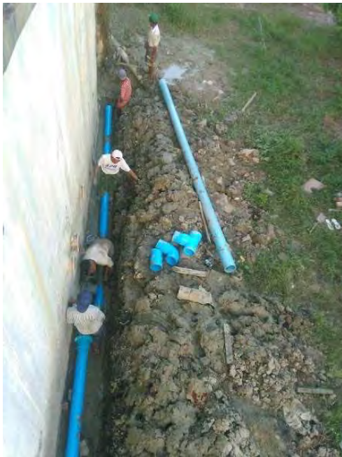
写真 2-70 : Phase1No. 1 沈殿池に増設された排泥パイプ (沈殿池外部)
