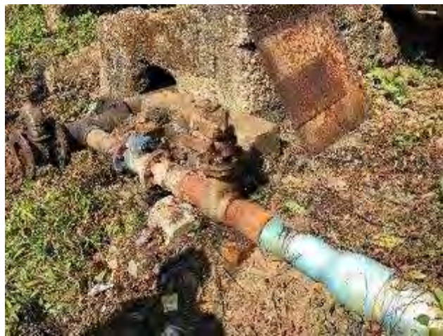
写真 2-58 : ジョビュー送水管に近接設置の破損メータ
