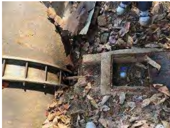
写真 2-37：送水管継手部からの給水管分岐
