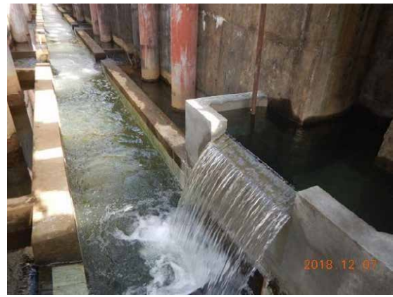
嵩上げされた流出堰 (Phase1 パイロットろ過池)
