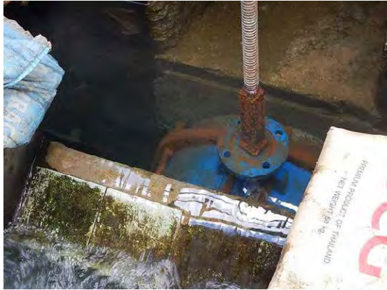
取り替えられたろ過池流出弁 (Phase1 パイロットろ過池、流出堰は嵩上げ前)
