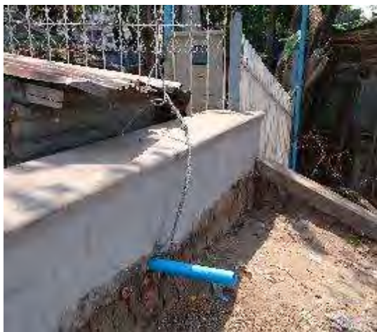
写真 2-56：給水船への補給施設
