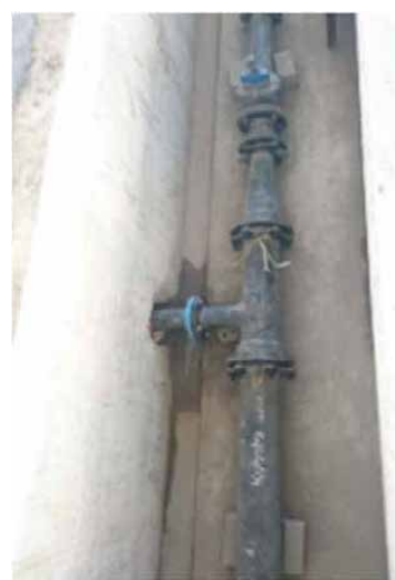
地下ピット内配管
