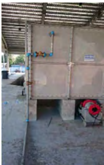
貯水タンク流入配管
