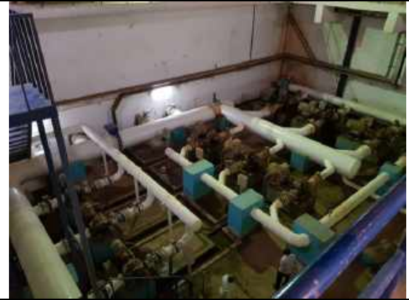
写真-10：北部州浄水場。超音波流量計設置対象。屋内には設置スペースが無いため屋外にボックスを建設して設置する（北部州）。
