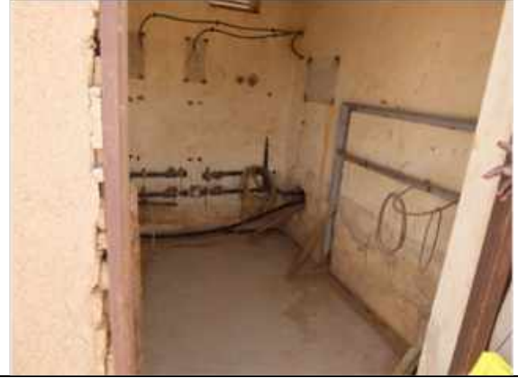
写真-8：カッサラ西浄水場の塩素注入装置設置予定個所（カッサラ州）。
