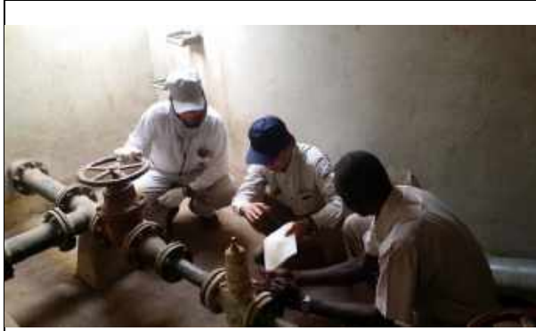
写真-13：故障した減圧弁の状況を調査する調査団員（ハワタ・ワドエラガエイリ地区）。
