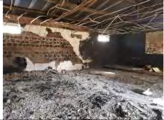
写真-20：暴徒化したデモ隊に焼き討ちされた事務所内部（ゲダレフ州水公社）。
