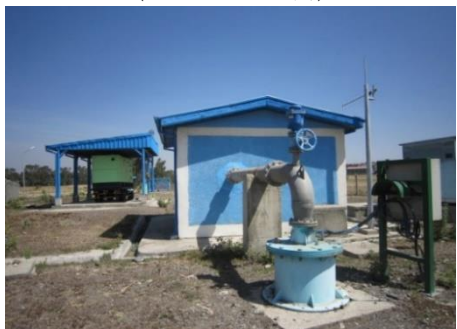
Condomニウム（開発団地）用水源井戸（Akaki Branch 内）
