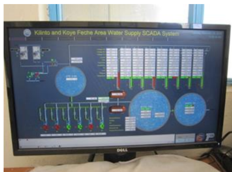
コンドミニアム団地用井戸群の SCADA システム
