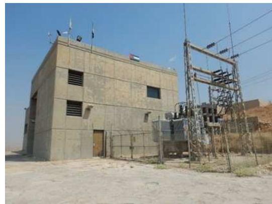
محطة ضخ المياه الخام
