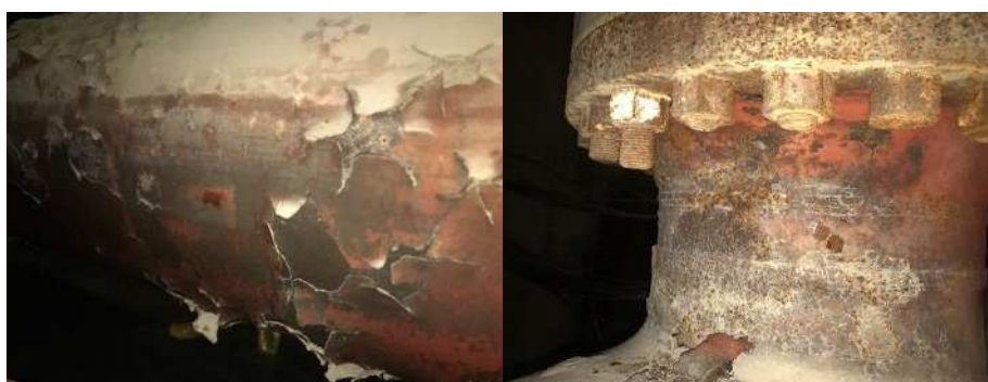
図4 塗装劣化状況、腐食状況
