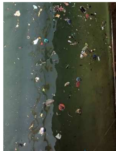
写真-2 浄水場の濾過池に浮遊するゴミ
