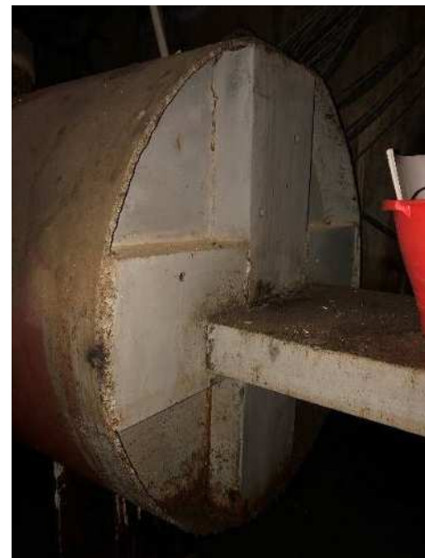
写真- 9 ヘッダー管末端部
