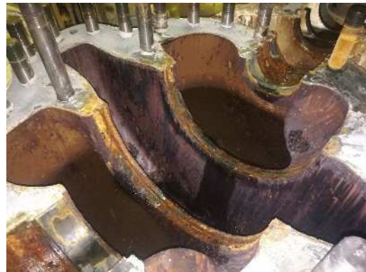
写真-7 ケーシング内部
