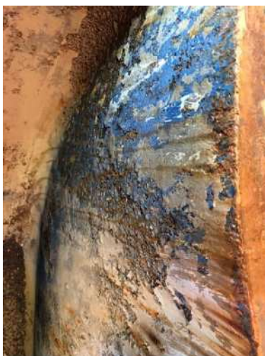
写真- 4 ケーシング内面の腐食
