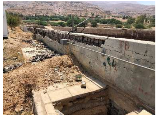
写真- 11 沈砂池コンクリート膨張状況
