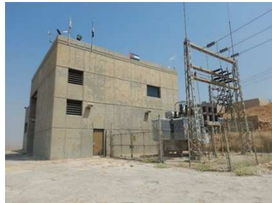
محطة ضخ المياه الخام
