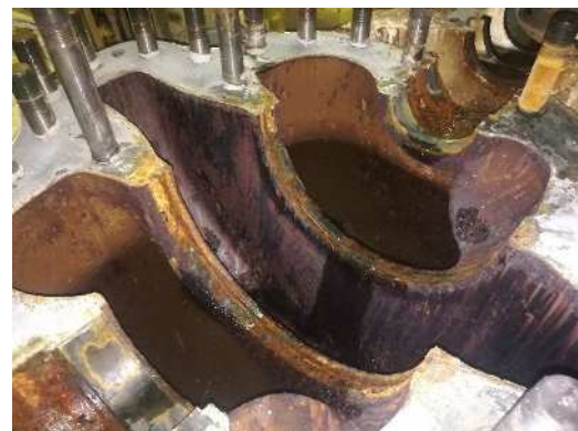
写真-7 ケーシング内部
