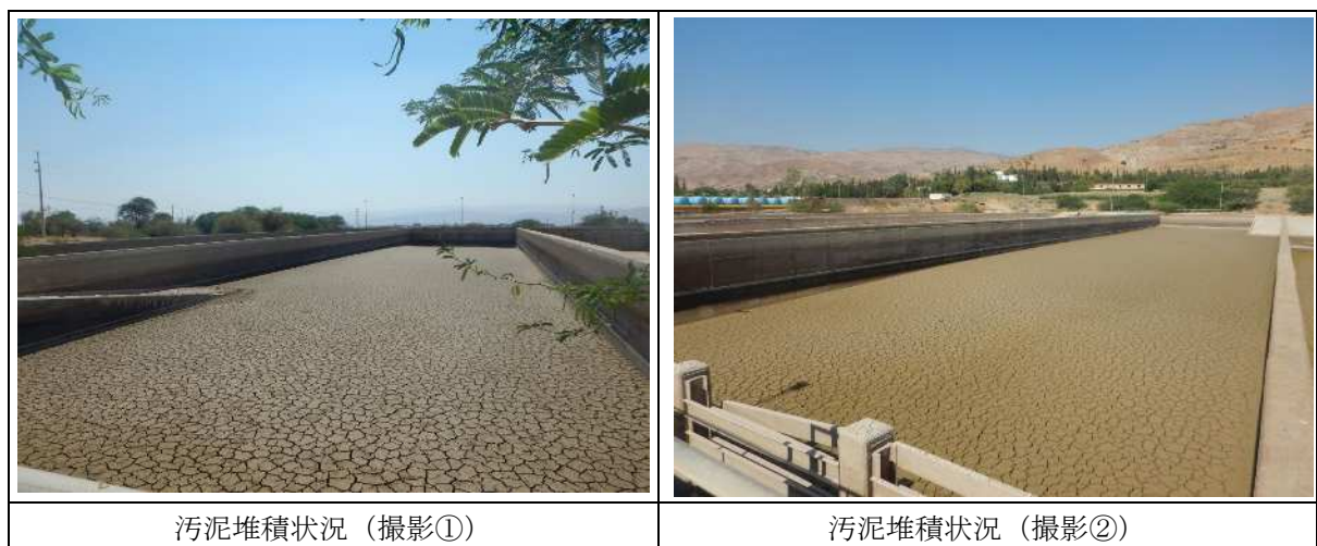
写真- 13 沈砂池 No. 2 汚泥堆積状況
