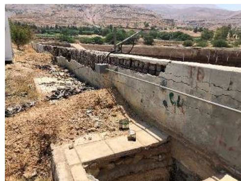
写真- 11 沈砂池コンクリート膨張状況
