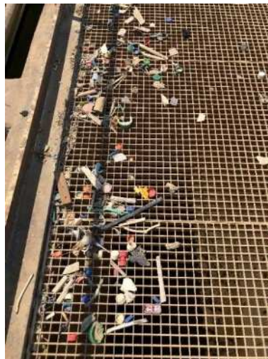
写真- 1 取水ポンプ後の 沈砂池で収集されたゴミ
