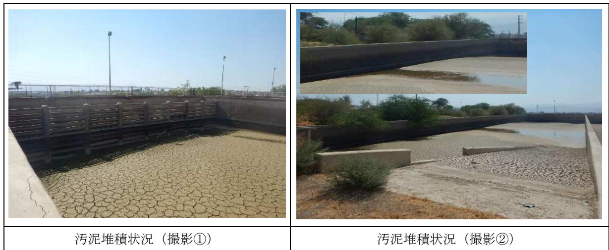
写真- 12 沈砂池 No. 1 汚泥堆積状況
