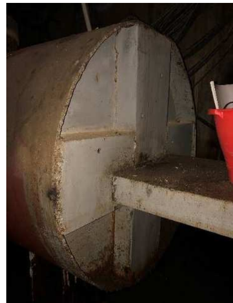
写真- 9 ヘッダー管末端部
