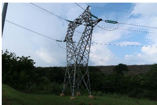
Premier pylône de la ligne de transport de 225 kV existante (entre les postes Kossou et Bouaké 2)
