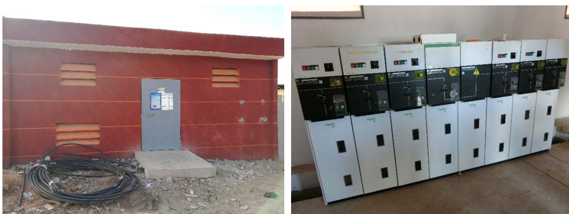
Fig. 4.3-5 Poste de réflexion (left: outside, right :switching gear)
