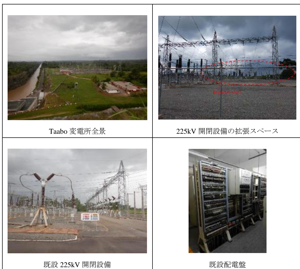
図 4.2-3 Taabo 変電所の各設備
