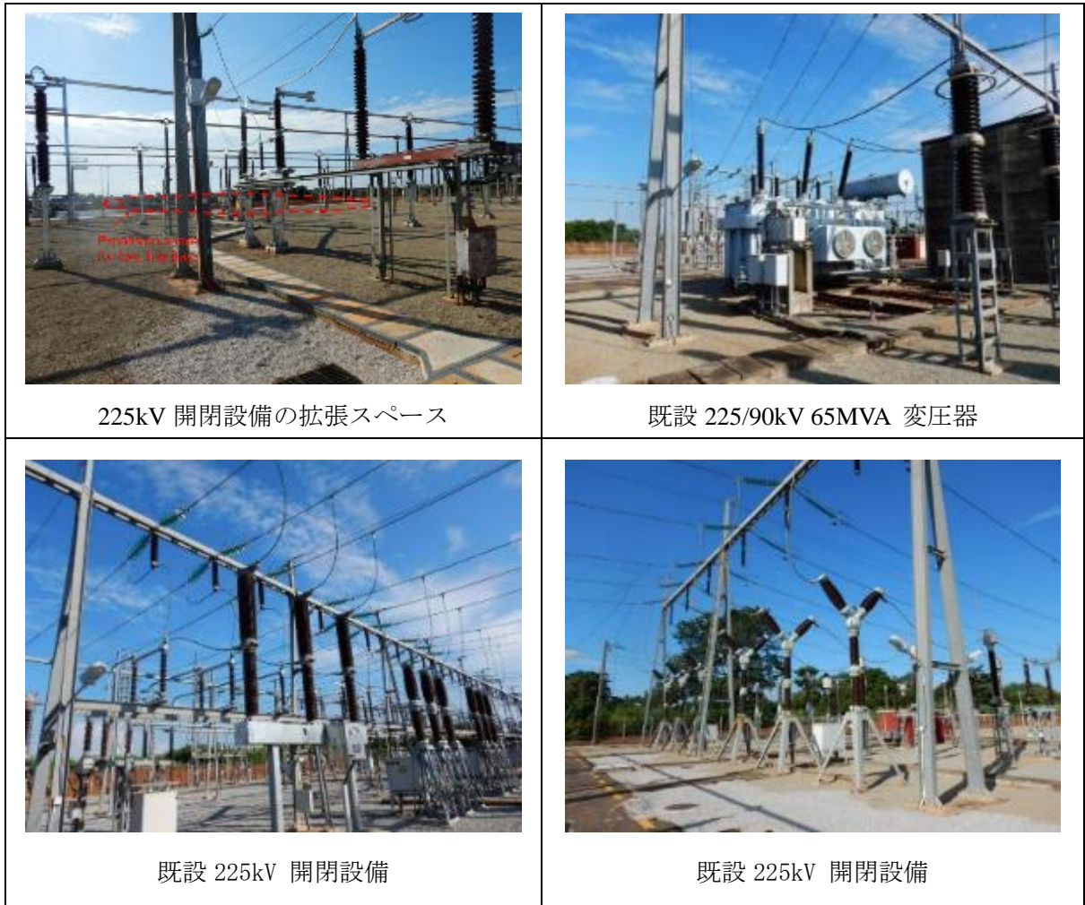
図 4.2-9 Bouake 2 変電所 各設備
