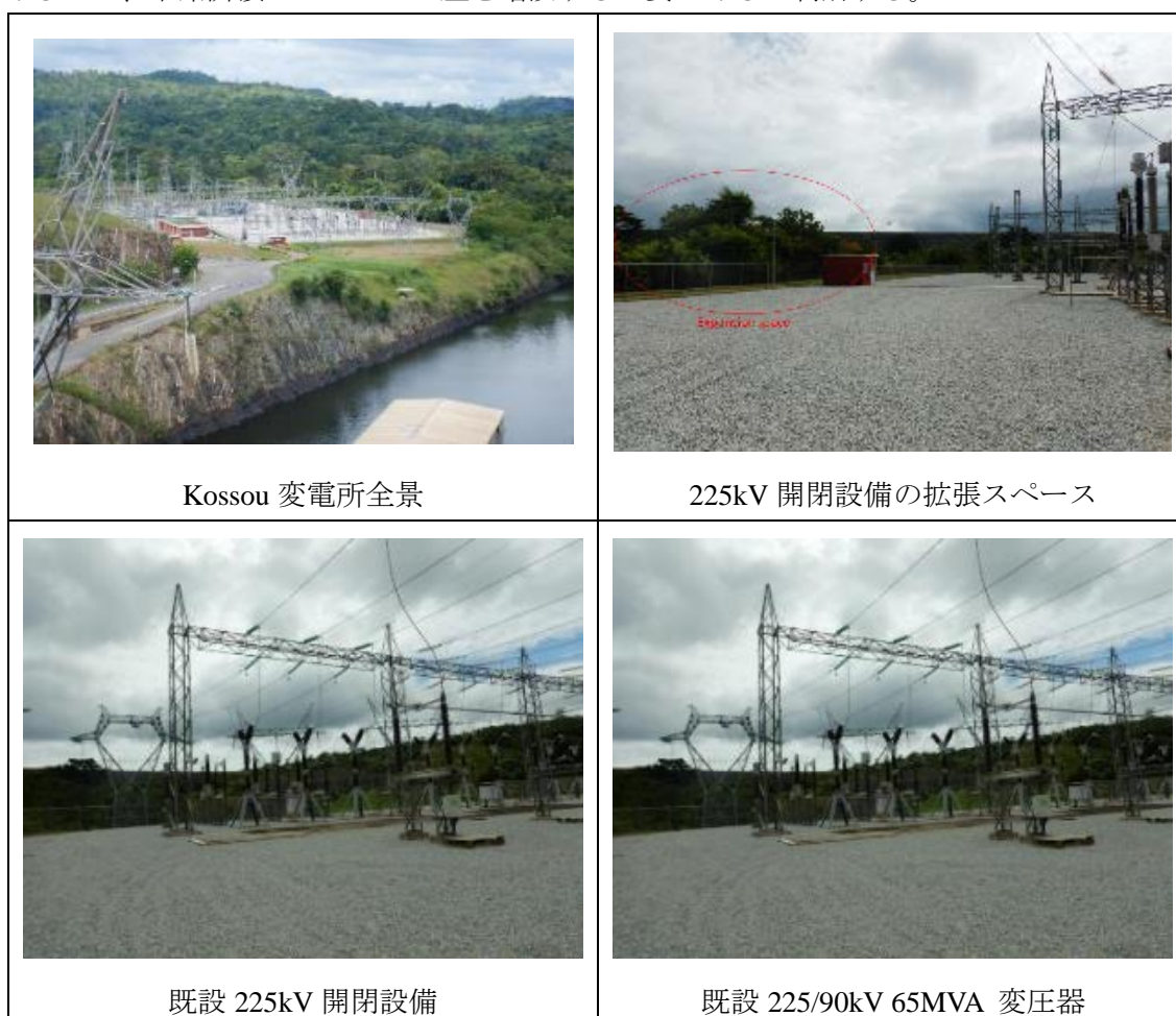
図 4.2-6 Kossou 変電所の各設備
