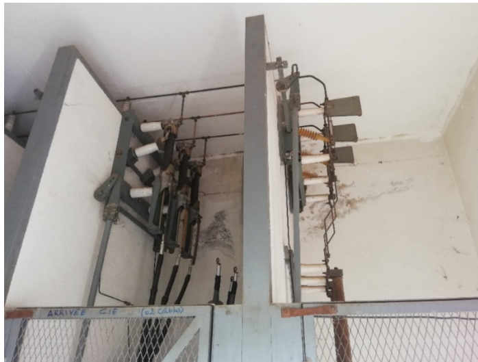
図 6.4-2 配電ポスト P39 内部
