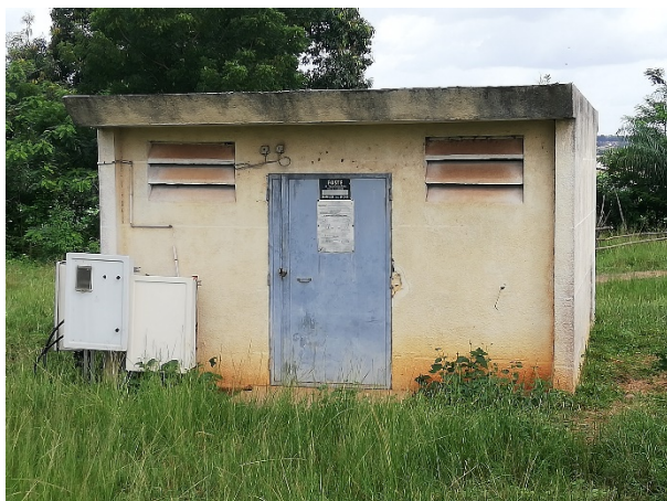
(配電ポスト建屋)
