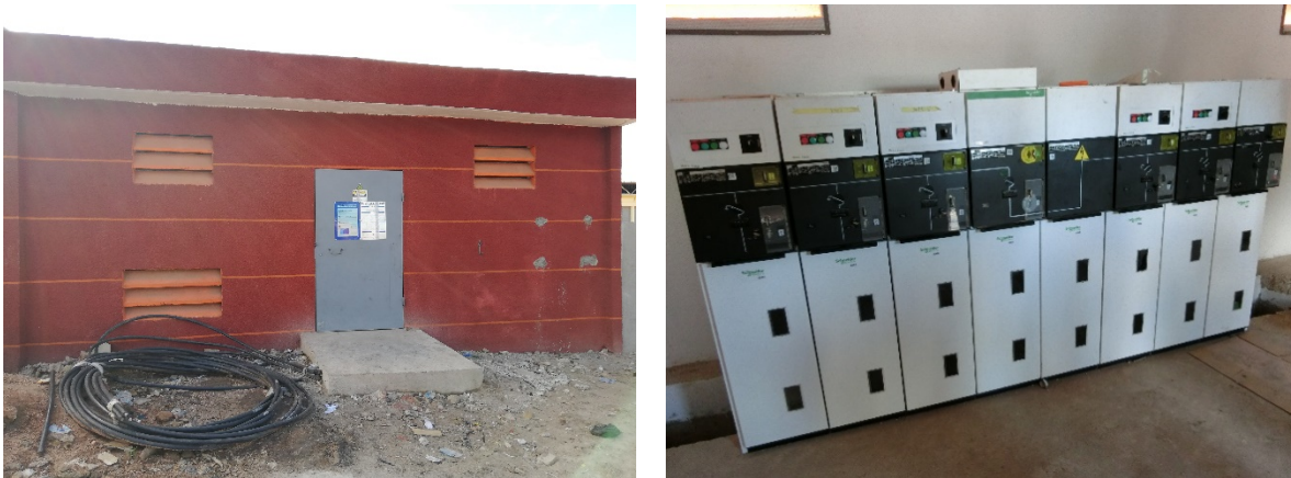
図 4.3-5 Poste de réflexion(左:外観、右:開閉装置)
