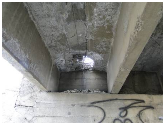
(а) Гэмтсэн (ховхорсон) төмөр бетон хучилтын хавтангийн доод тал
