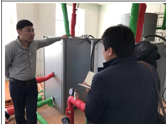
地中熱ヒートポンプ本体
