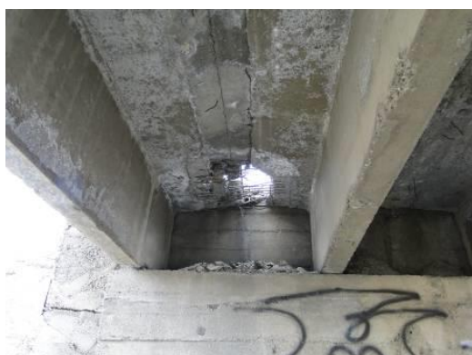
(a) 損傷(陥没)した RC 床版の下面
