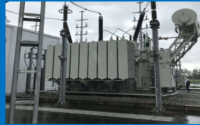
အရှေ့ဒဂုံ 230kV ဓာတ်အားခွဲရုံ
