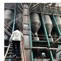
b.c.パーボイルタンク
