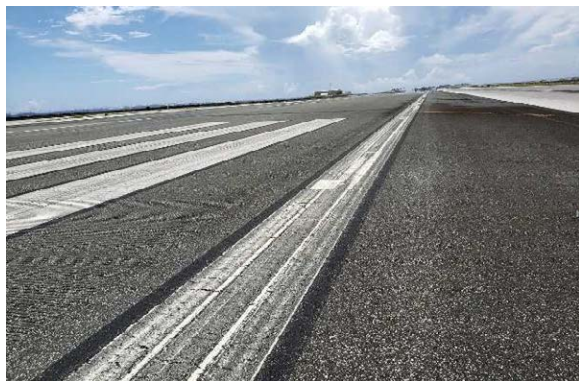
マジュロ国際空港の滑走路 雨水集水施設としても利用
