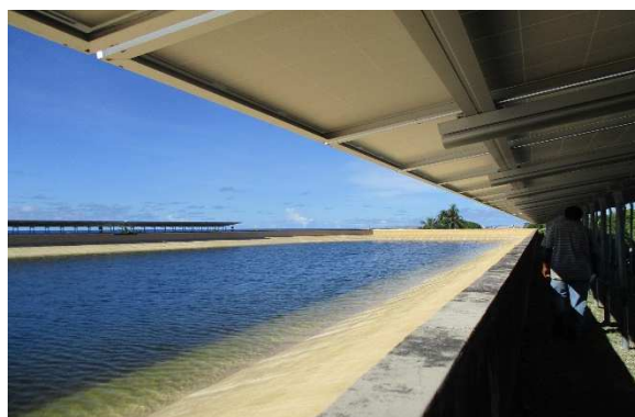
貯水池 No.6 上部は太陽光発電システムのパネル
