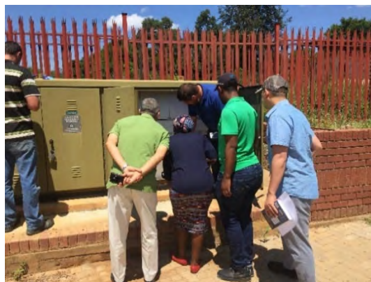
写真 44 研修ヤード電気設備の確認
