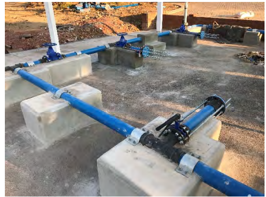
写真 108 研修ヤード（配管接続等研修エリア）
