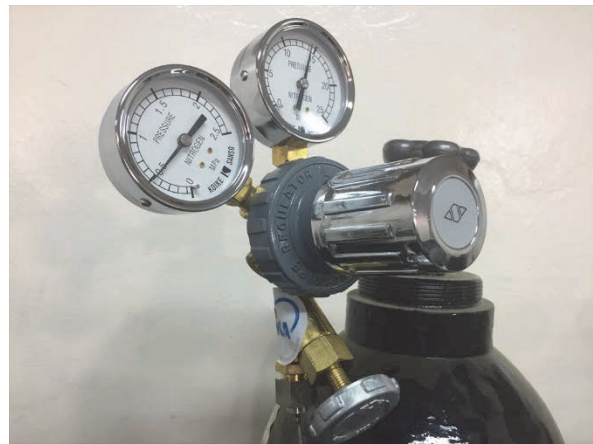
写真 2.2-23 減圧器 N2 用
