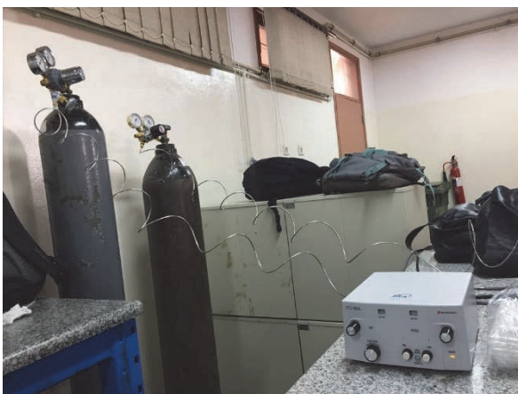
写真 2.2-24 キャリアガス導管 5m
