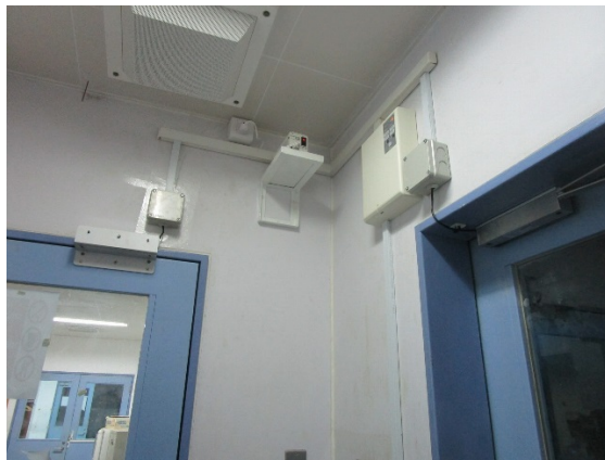
電磁式面付けインターロック及び制御盤
