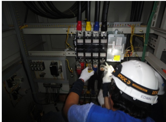
ATS 交換作業
