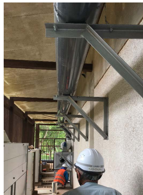
局所排気ファン及びダクト
