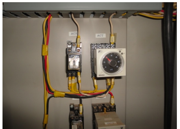
新設タイマー
