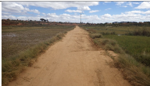
20) Vue de la piste agricole d'Ambatolampy Tsimahafotsy, région d'Analamanga. Les routes en terre semblent dégradées, et des réparations sont nécessaires pour l'utilisation de charrettes tractées par des bœufs ou de tracteurs.
