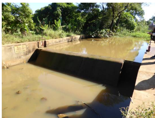
Le barrage du périmètre de micro-irrigation de Marovantaza du district d'Analalava, superficie bénéficiaire d'environ 140 ha et longueur du canal principal de 3km
