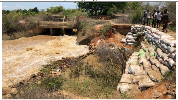
6) Canal d'irrigation réparé avec des sacs de sable par l'Association d'usagers de l'eau. L'entretien des ouvrages se fait par les frais d'eau collectés, les associations en fonctionnement sont assez nombreuses, mais la gestion des vannes des partiteurs est particulièrement difficile. District de Mahabo, région de Menabe.
