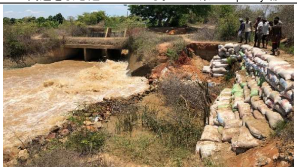
6) 水利組合連合が土のうで補修した灌漑水路の様子。水利費の徴収により保守管理を行い、機能している水利組合は少なくないが、分水工のゲート管理が特に難しい。Menabe 県 Mahabo 郡
