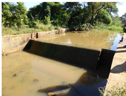
Analalava 郡 Marovantaza マイクロ灌漑地区頭首工 受益面積約 140 ha、主水路 3 km
