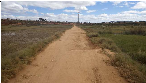
20) Analamanga 県 Ambatolampy Tsimahafotsy 灌漑地区の農道の様子。土道路の劣化が見られ、牛車やトラクタなどの利用のためには補修が必要である。
