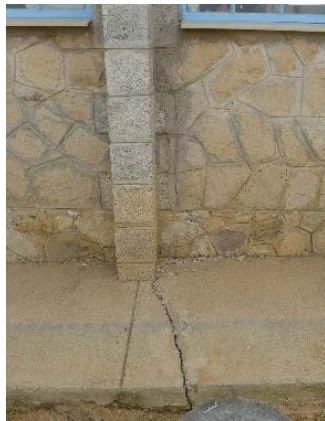
不具合の状況: 南側外部土間のクラック
