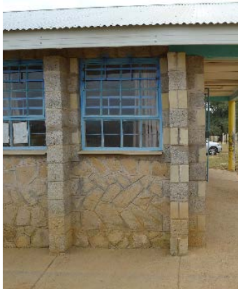
不具合の状況: 柱が傾いている
