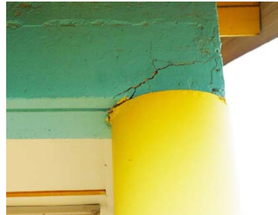
不具合の状況: ポーチ柱頭のクラック
