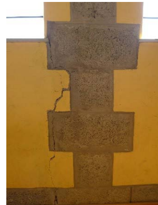
不具合の状況: 教員室内部壁のクラック
