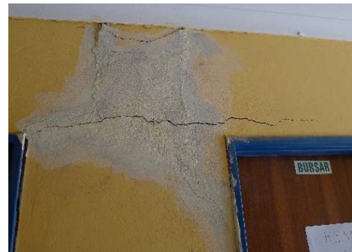
不具合の状況: 対象校による補修後、再度クラックが発生
