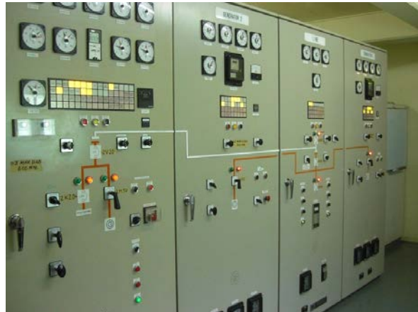
運転室 （発電所建屋 2 階の運転室では、4 交代 2 名体制で 24 時間勤務）
