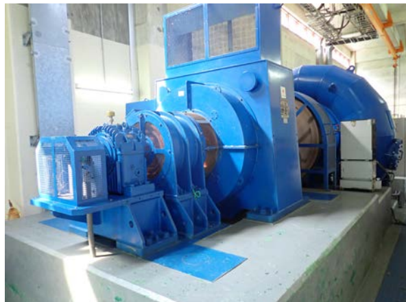
水車発電機 （2009 年の増設工事で設置された 3 号機 出力 600kW）
