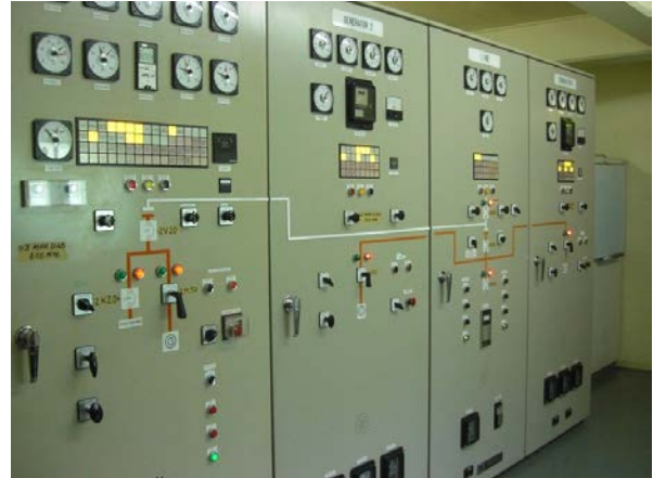
運転室 （発電所建屋2階の運転室では、4交代2名体制で24時間勤務）
