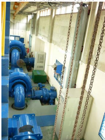
水車発電機室 （手前から1995年に設置された出力各300kWの1,2号機及び2009年に設置された出力600kWの3号機で全て横軸フランシス水車）
