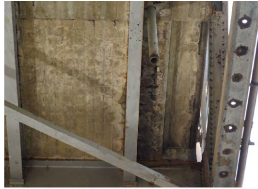
写真-16: 既存橋床版 (下床版鉄筋露出)
