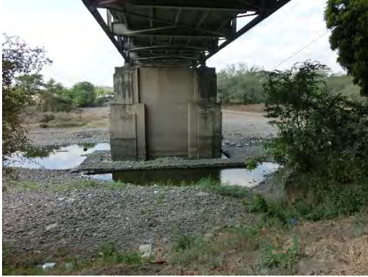
写真-13: 既存 P1 橋脚遠景 (洗堀状況)
