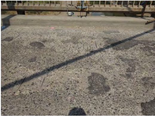
写真-15: 既存橋路面 (上床版鉄筋露出)
