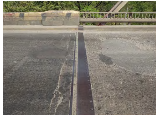
写真-18: 既存橋伸縮装置 (土砂詰まり)
