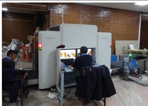
写真 3.5-3 新設された受託手荷物用 X 線検査装置
