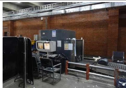
写真 3.5-4 改修前の受託手荷物用 X 線検査装置
