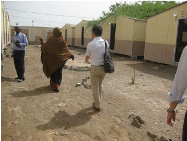
写真 19: Hayel Said 中学校少人数教室。軽量鉄骨プレファブ造で作られた仮設教室で、断熱性能が低く、室内環境は劣悪である。
