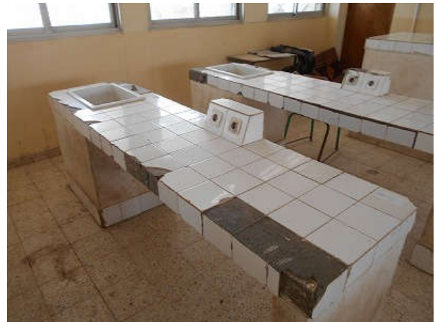
写真 4:Fukuzawa 中学校理科実験室。実験台はタイルの剥がれや水栓、電源コンセントの破損で十分な利用ができない状態にある。
