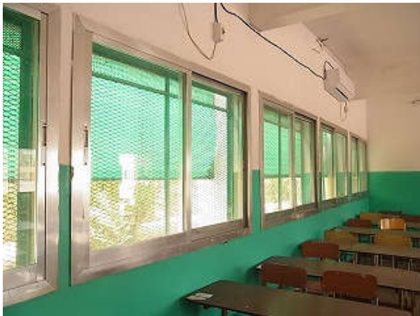
写真 9: Boulaos 中学校一般教室。窓の外部に投石に対するガラス防護用エクスパンドメタルと、日射遮蔽用ポリカーボネート波板、屋内にはエアコンが設置されている。
