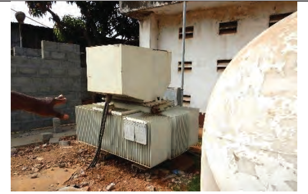
電気設備：母子病院及び周辺をカバーするトランスが置かれている。容量不足の上に停電が多い。
