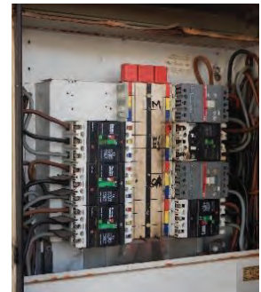
写真 2-6 敷地内配電ボックス
