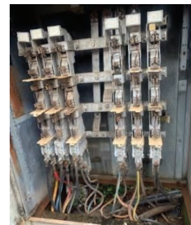
写真 2-12 ラムリー病院配電盤
