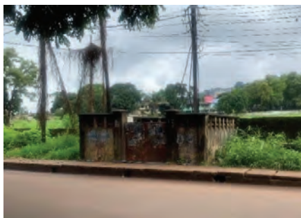
写真 2-10 ラムリー病院変電施設
