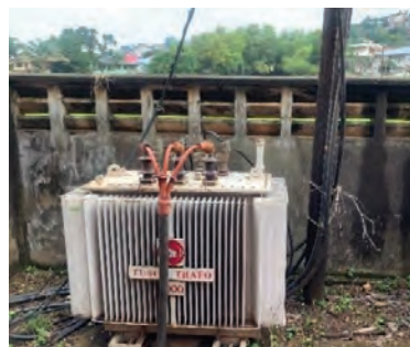
写真 2-11 ラムリー病院トランス
