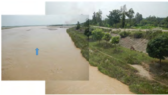
図 16 右岸堤防に設置された護岸 河川水の濁度が高く、土砂濃度が高いことが推察される。
