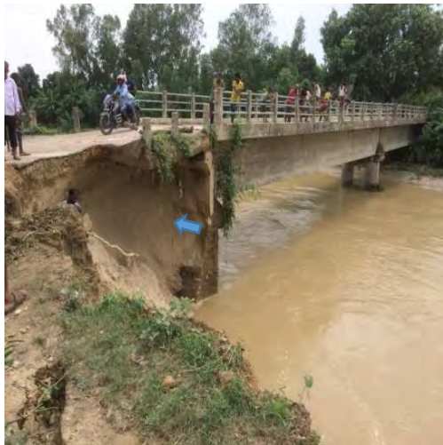
図 2 Janakpur ~ Yadukuha における取付道路盛土の被災（Province 2）
