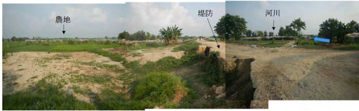
図 12 周辺農地より、土砂堆積により高くなった河道 洪水時には堤防を越流するリスクが増加している。
