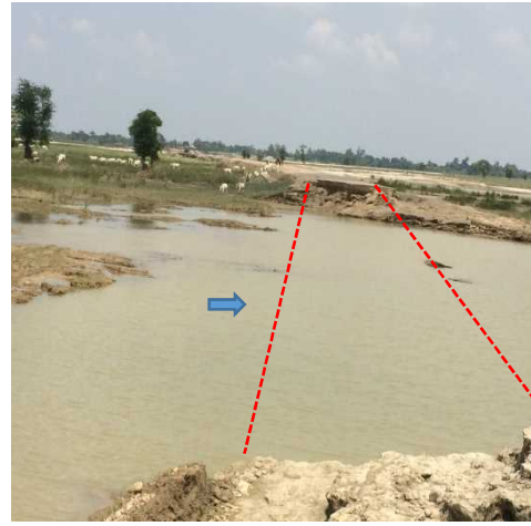
図 5 Janakpur ~ Kaptol Kamala における盛土被害 (Province 2) ②
