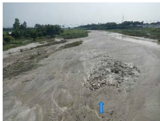
図 20 同橋梁下流側河床 土砂が堆積している様子。
