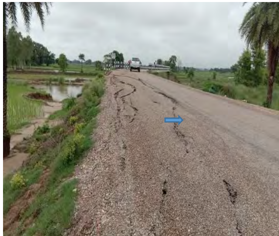
図 6 Bagamati ~ Aruwa における舗装の被災①
