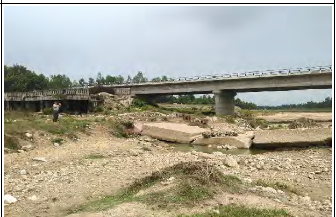
タライ地域河川橋脚崩落の状況 (2019/09/16)
