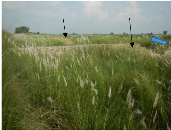
図7 鉄線籠で造られた水制① 破堤箇所の下流側に2基設置されている。
