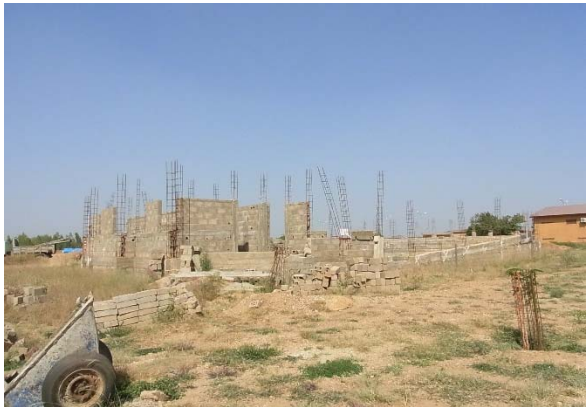
写真8. 類似校（ENEPテンコドゴ）：講堂 学校規模に対して、収容人数が少なく、工事途中 で中断されている。計画内容の見直し中。
