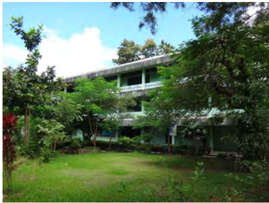
3階建て TTC 教室棟：50年ほどの築年数であるが、維持管理がされており継続使用が可能である。
