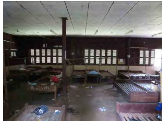
男子学生寮：老朽化した木造棟で、白蟻被害も受けており、継続使用が困難な状態である。
