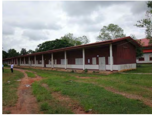
TTC 教室棟：1992 年に建設された木造平屋建て教室棟。一部白蟻被害が確認されたが、改修を含めた維持管理がなされている。
