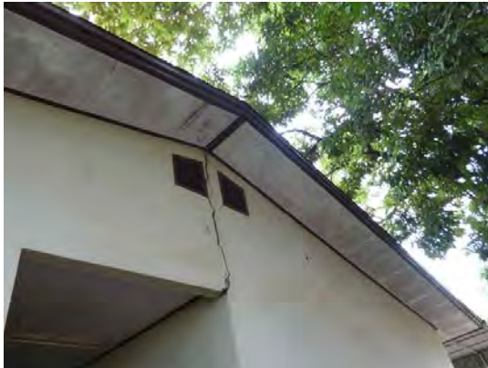
付属幼稚園：建物の半分が不同沈下しており、妻壁上に大きなクラックが入っている。
