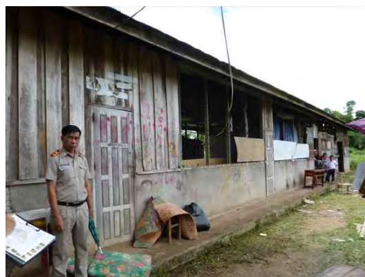
付属校小・中学校：極めて状態の悪い木造校舎。2 教室中 1 教室が小学校、もう 1 室は中学校の教室として使用されている。
