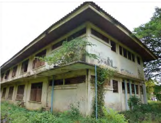
女子学生寮：2階建て RC 造。建物の構造劣化と劣悪な衛生環境から、継続使用困難である。一部棟は使用が中止された。
