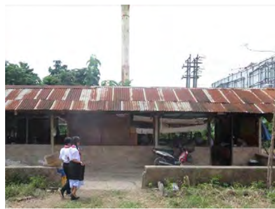
付属小学校（木造校舎）：老朽化による損傷が激しいため、一時使用中止していたが、教室不足により使用再開した。
