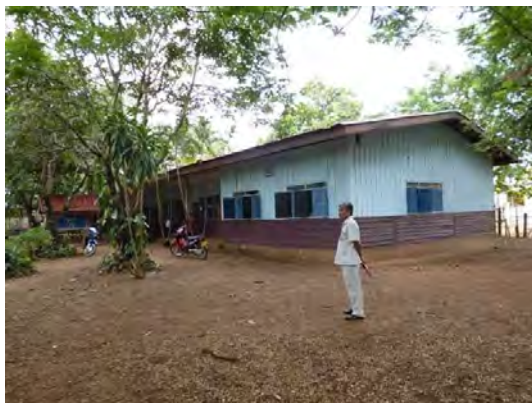
付属小学校：建設後 50 年以上経過した木造校舎であり、継続使用が困難である。
