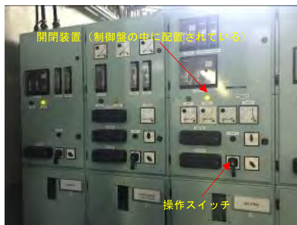
図 5-4.7 Katse 既設開閉装置
