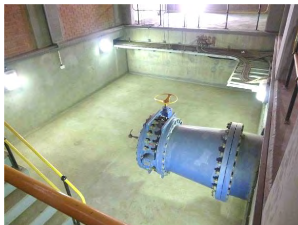
Mohale ダム放流弁室内の発電設備区画
