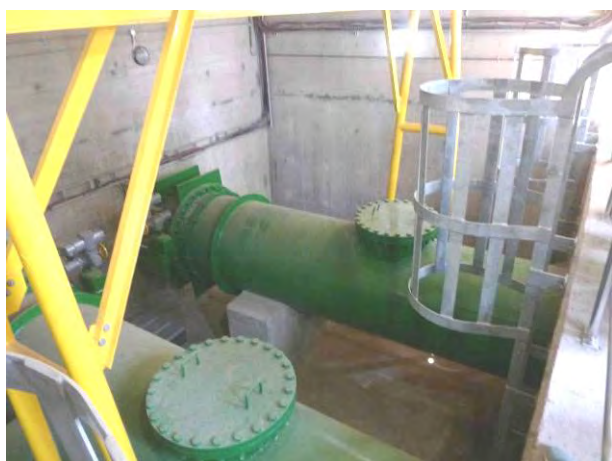
Metolong ダム放流弁室
