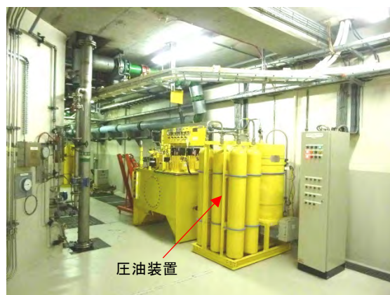
図 5-4.23 水車圧油装置
