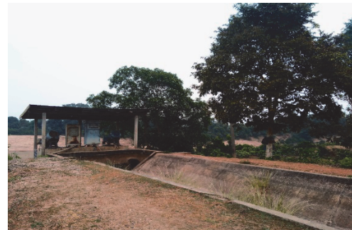
トンヘン (Tonhen) 地区の灌漑施設
