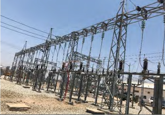
220/33kV Zuzu Substation (Switchgear)
