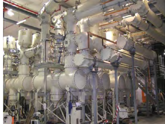
(b) 330 kV GIS
