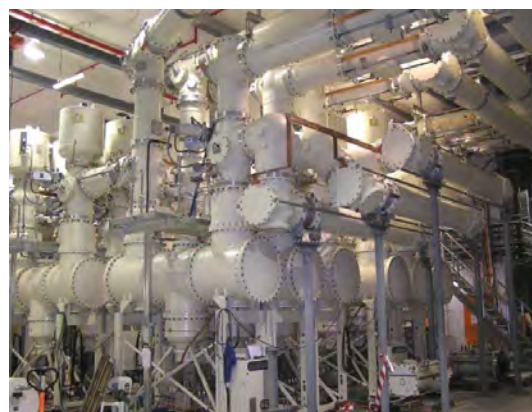
(b) 330kV GIS
