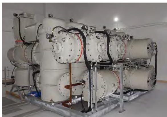
(a) 145kV GIS
